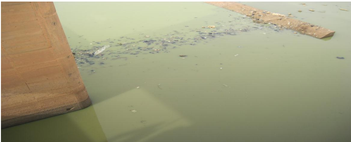
Figure 6 : Pollution de l'eau du barrage
